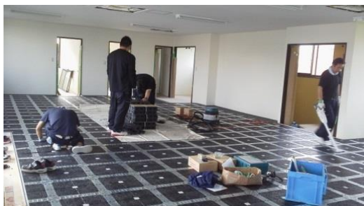
OAフロアの新設・電話工事 ネットワーク工事もお任せください
