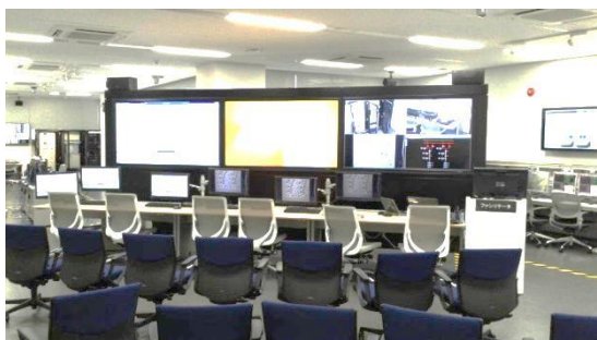
写真① 模擬中央監視卓。 最先端なITシステム・オフィスシステムを体感出来ます！
